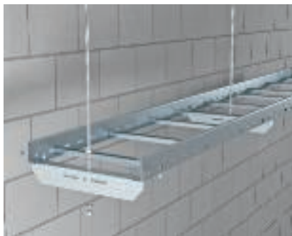
Středový závěs kabelového žebříku se závitovou tyčí
